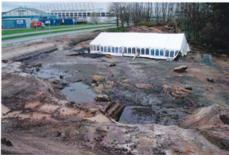
Fig. 5. Gjennom den lange feltsesongen i 2014 hadde vi til saman fem telthallar over dei ulike utgravingsobjekta. Her ser ein det største teltet som var på 250 m 2 . Dette stod i fleire månader over dei sentrale delane av lokalitet 9. Foto: Arkeologisk museum.
